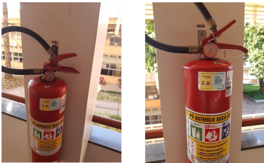
Figura 1: Extintores de incêndio contendo pó químico, com identificação na parede indicando \text{CO}_2 e \text{H}_2\text{O}
