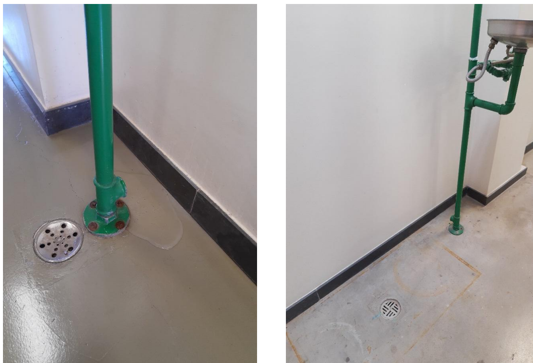
Figura 2: Tubulação aberta e poça de água formada após acionamento de lava-olhos dos laboratórios do Anexo 1
